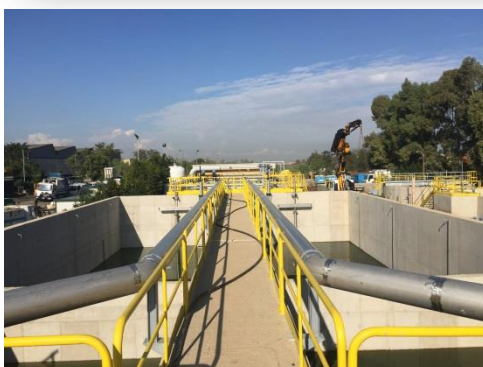
CIAMPINO (RM) IMPIANTO DI DEPURAZIONE
